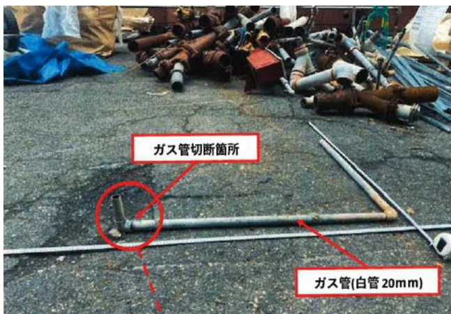
切断されたと思われるガス管
