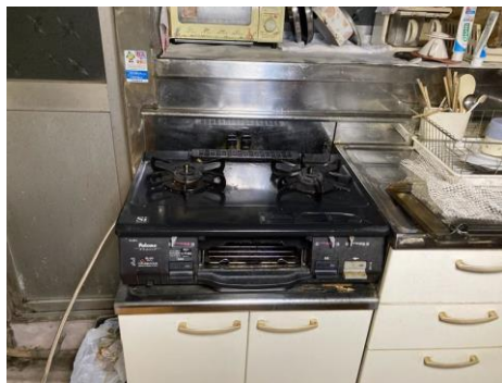
こんろ設置状況
