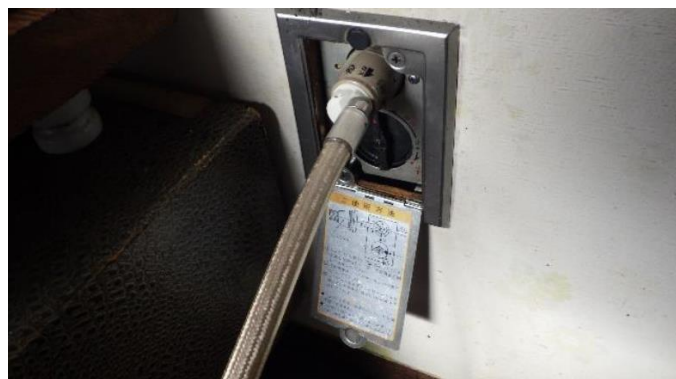
ガス栓及びガスコード
