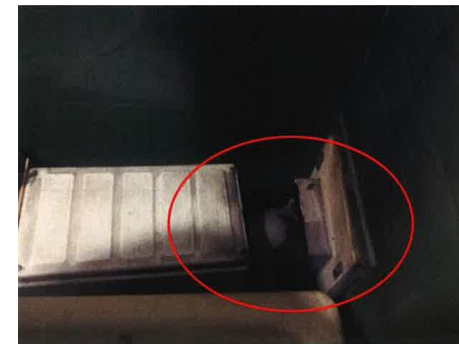
給排気筒の給気部の破損
