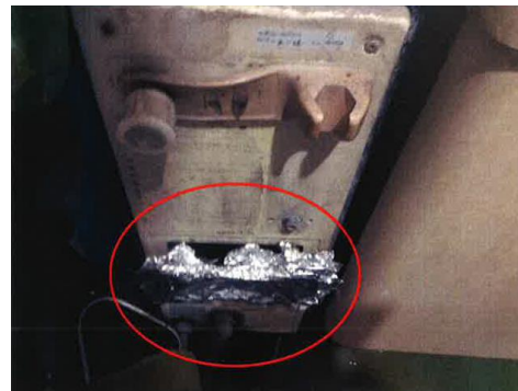
点火確認窓の破損
