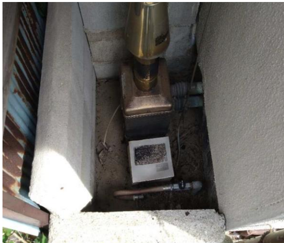
風呂釜（CF）焼損状況
