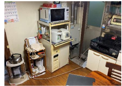
ガストーブ設置状況
