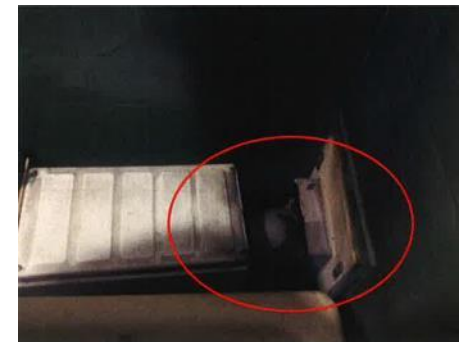
給排気筒の給気部の破損
