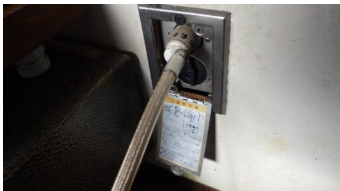
ガス栓及びガスコード
