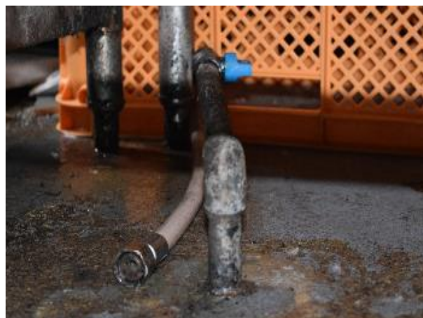
消費機器が接続されていない可とうガス栓
