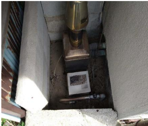
風呂釜（CF）焼損状況
