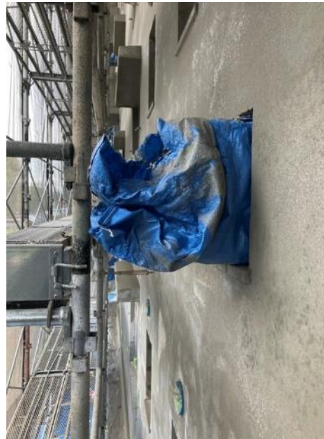
養生状況 (異常着火後)
