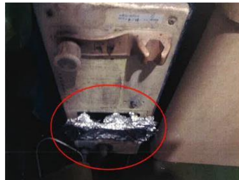
点火確認窓の破損
