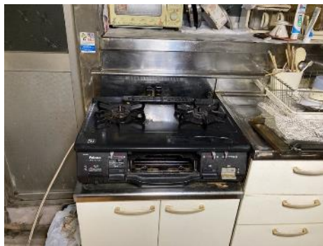
こんろ設置状況
