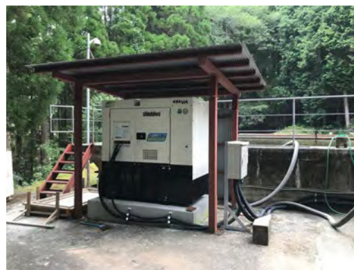
第5処理場（45kVA）
