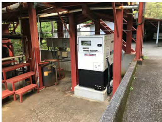
第2処理場（45kVA）
