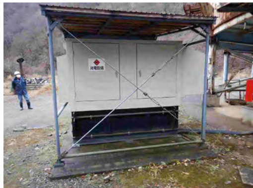
非常用発電機
