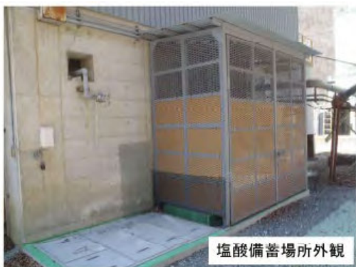
新設した中和剤の保管庫
