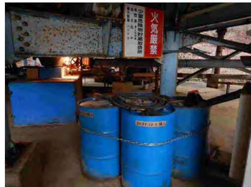
非常用発電機予備燃料
