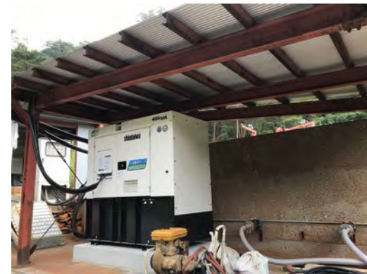
第5堆積場（45kVA）
