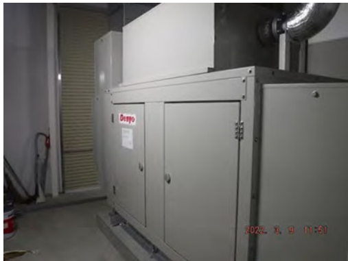
非常用発電機（145KVA）
