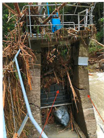
排砂門設備関係 破損
