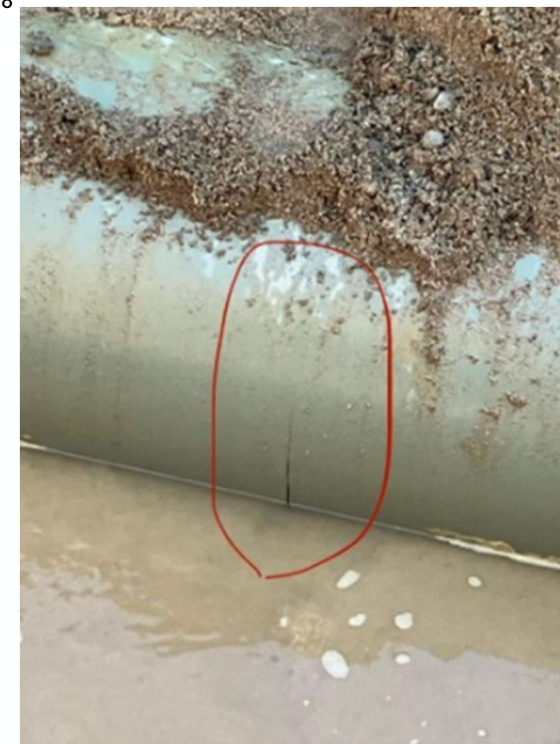
損傷した配管
