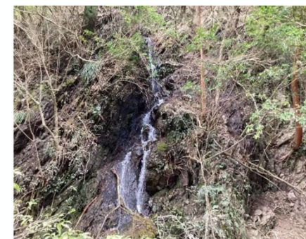
漏水箇所（補修前）
