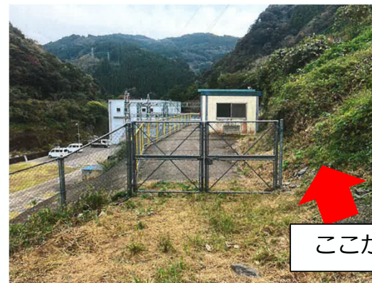
変電設備入口ゲート
