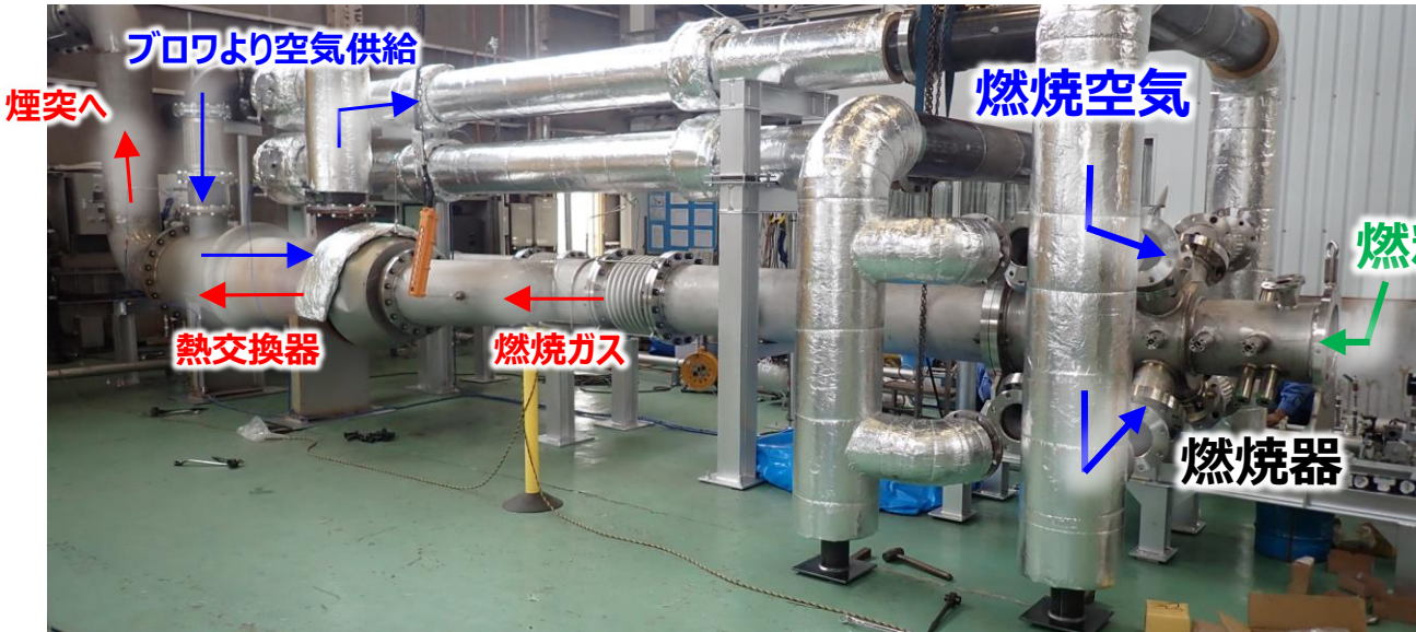
アンモニア燃烧試験装置
