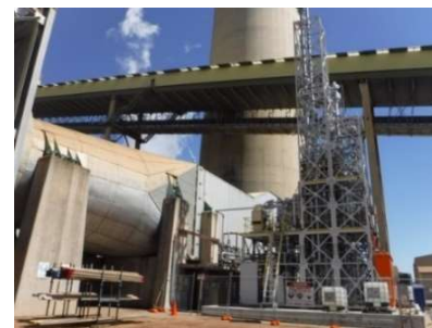
CO 2 回収設備
