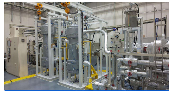
メタネーション設備
