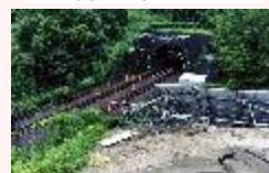
＜太陽光パネルの崩落＞
