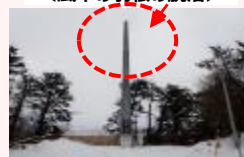
＜風車の羽根の脱落＞
