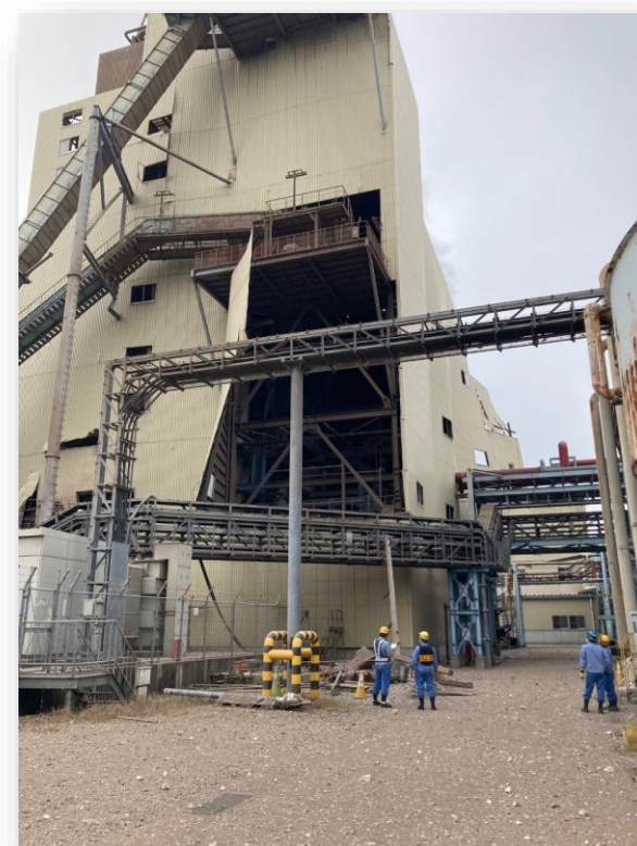
【破損状況写真】
