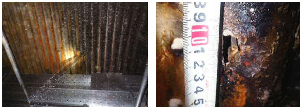
図8 ボイラー水管 破損箇所例
