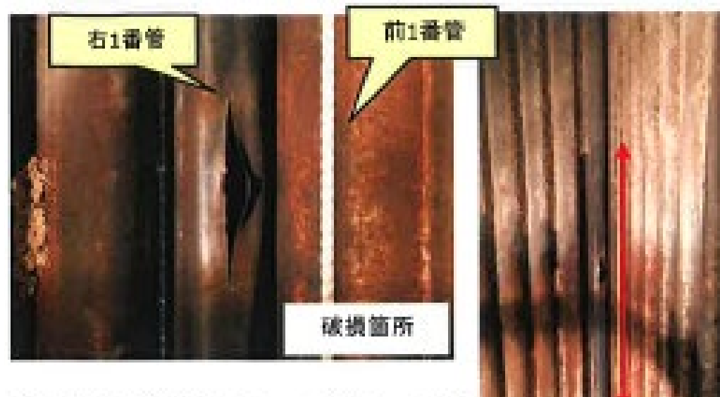
図5 エロージョン摩耗による破損例
