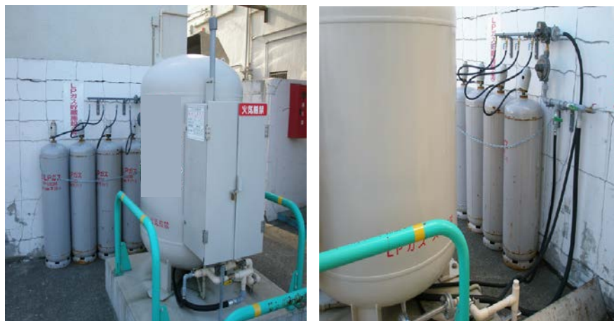
仮設供給設備のイメージ(例)
